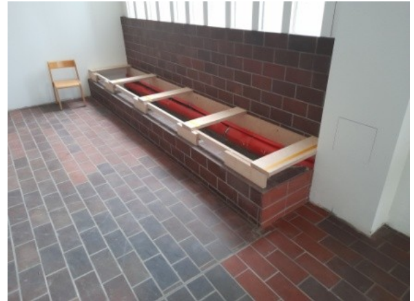
Weg des Abwassers vom oberen Behinderten-WC
