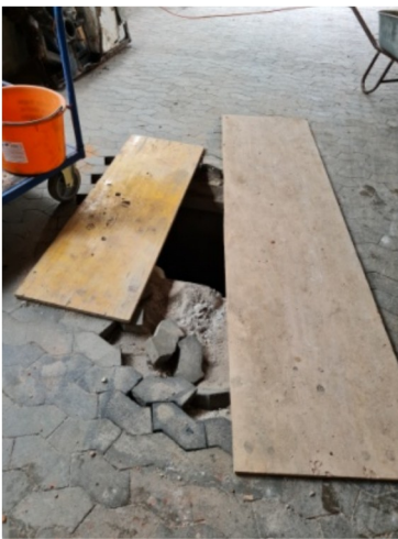
Problem der Drainage
